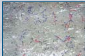
Razpoke v betonu brez dodatka FIBRILs
